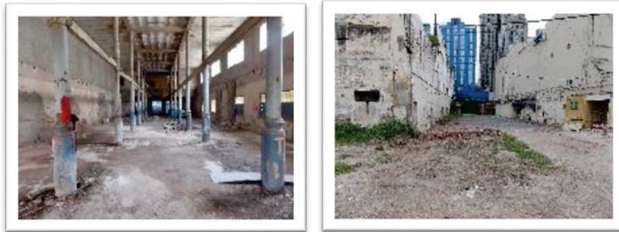
Figura 3.5. Estado de las parcelas en la primera inspección (Parcelas 2 y 3).
