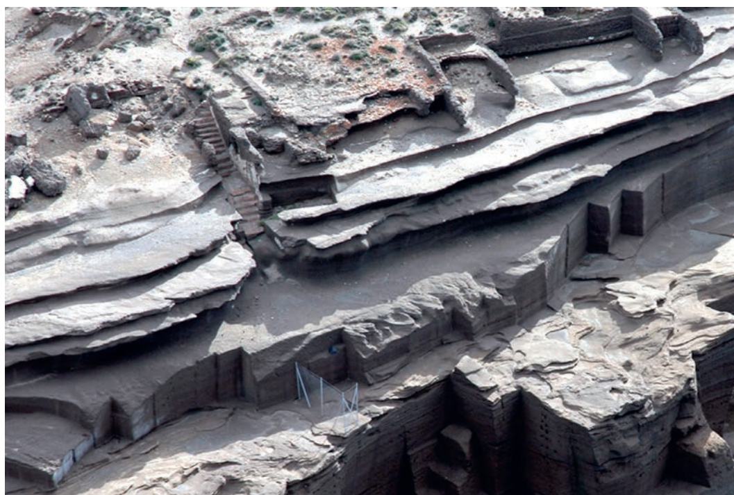
Figura 1.13. Punta Eolo, corridoio di discesa a mare A. 5, dopo il crollo della volta (foto Archivio De Rossi).
