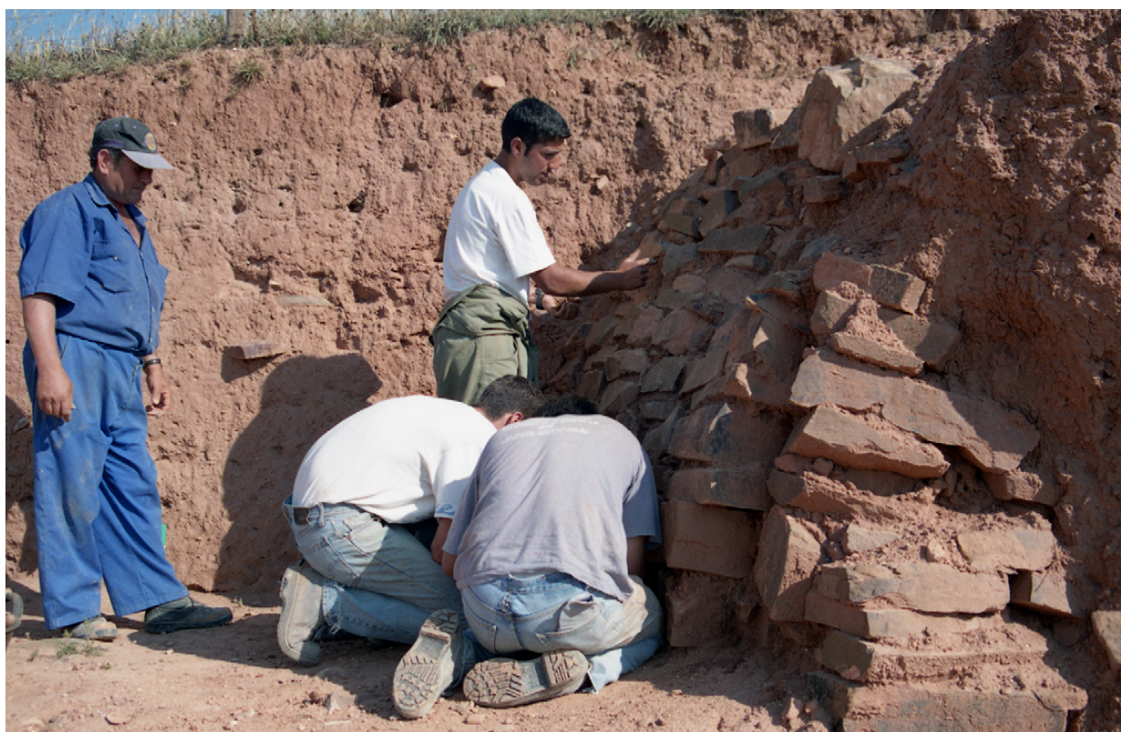
Figura 5. Tareas de restauración y consolidación en la muralla sur de El Cerro de las Cabezas. © Ayto. Valdepeñas. Archivo Fotográfico Cerro de las Cabezas, N° Inv. CC_00596 (1998)
