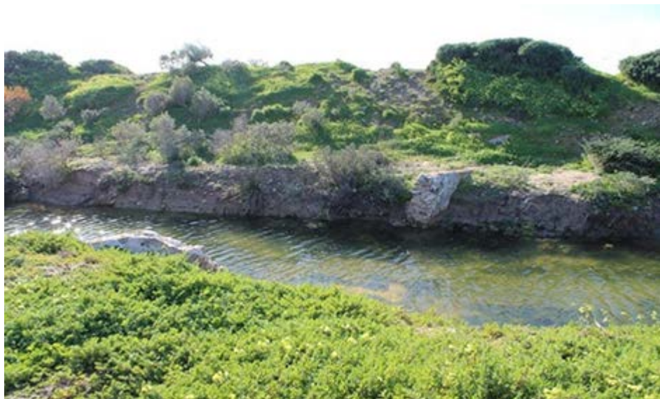
Figura 30: 2013. Pretil de la Calzada de la Alcantarilla seccionado al construir la gavia o canal de Camposoto a fines del siglo XX
