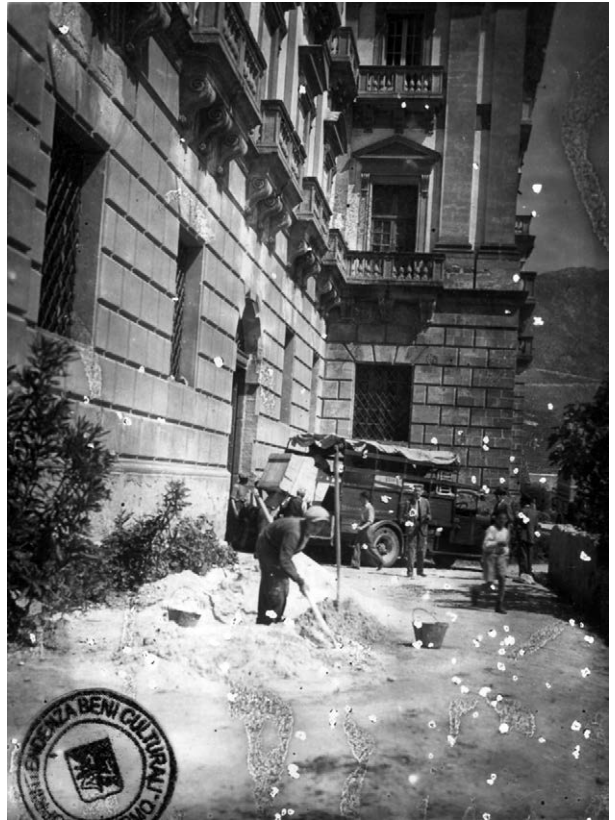
SMA.3.13 | ASSPAMON | pictures | 1 side | inv. no. 329 | 6x9 | San Martino delle Scale: workers mixing concrete in front of the abbey (courtesy of Soprintendenza ai Beni Culturali e Ambientali di Palermo ).
