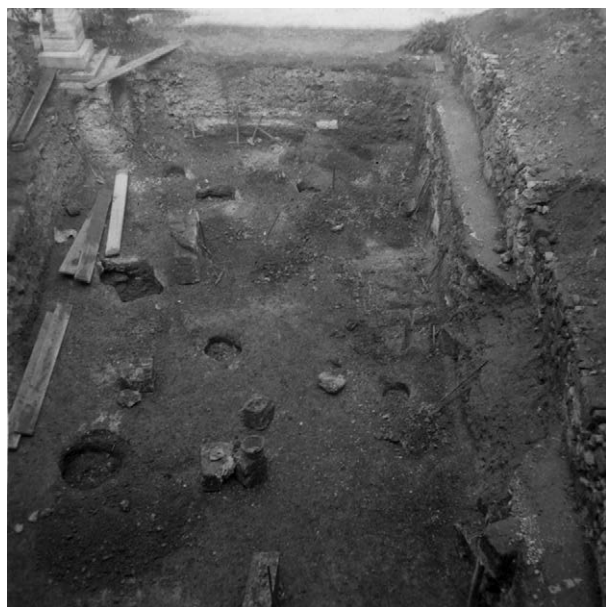
PAL.26.12 | AMARAS | pictures | 1 side | 1941 | inv. no. 8286 | Palermo, Biblioteca Nazionale : view of the construction site for the refuge. | 'Palermo (Biblioteca Nazionale). Scavo ricovero. Tombe' (courtesy of Museo Archeologico Regionale 'A. Salinas' ).
