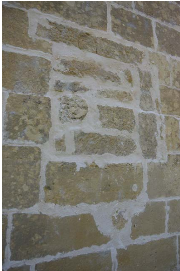
Figura 6.30. Ventana, ahora cegada, en la fachada occidental de la ermita.
