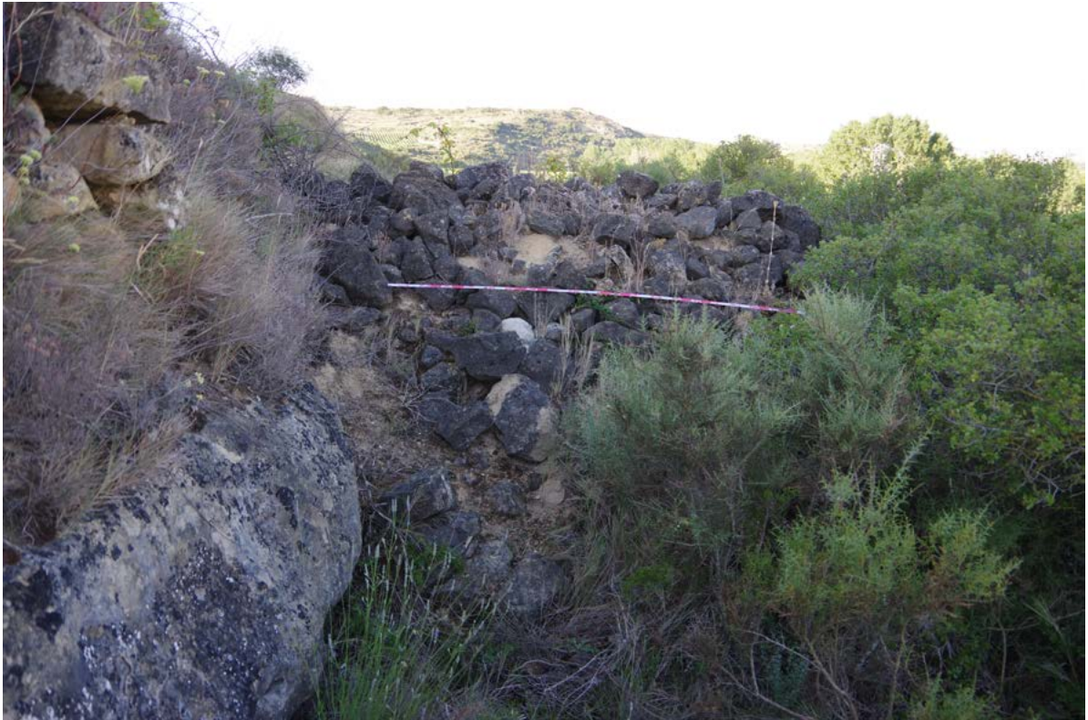
Figura 5.23. Derrumbes de muros de delimitación de las terrazas de Castrijo.
