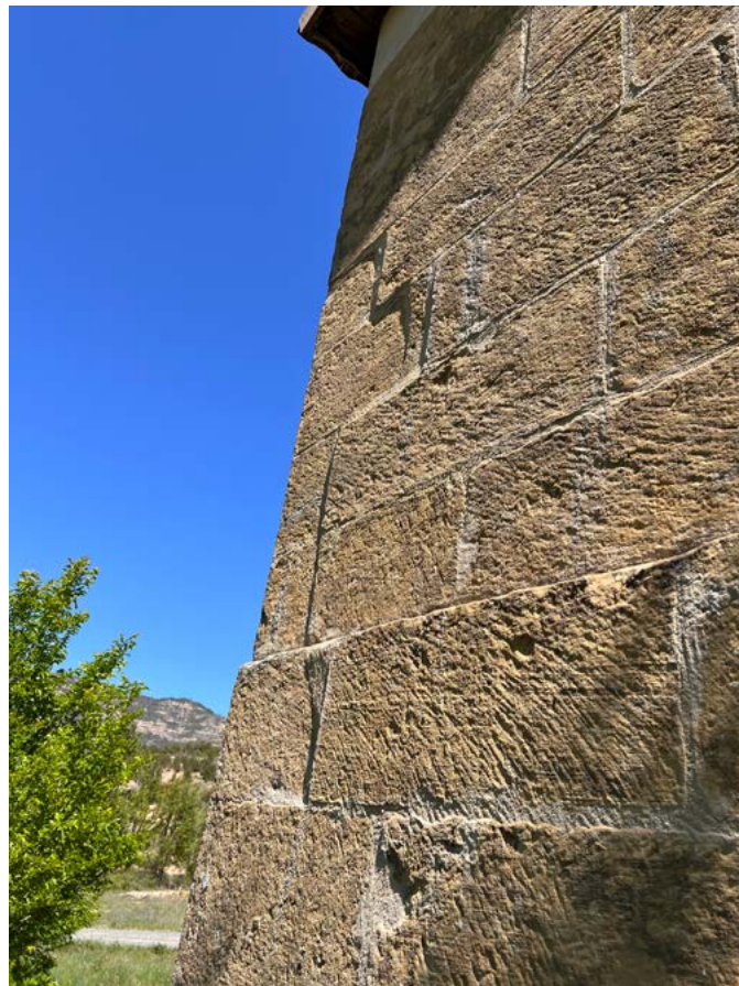
Figura 6.32. Discontinuidad en el paramento occidental de la ermita.
